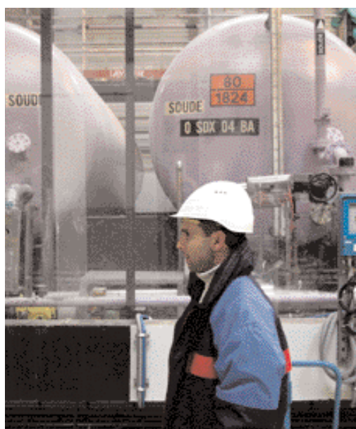
△ Station de déminéralisation.
