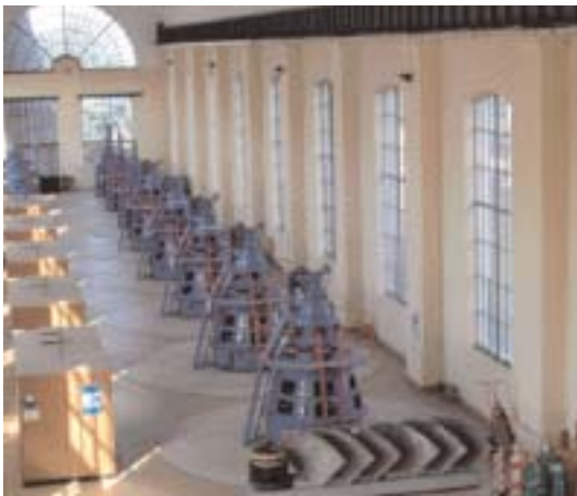
△ Centrale hydraulique de la Tuilière (Dordogne).
