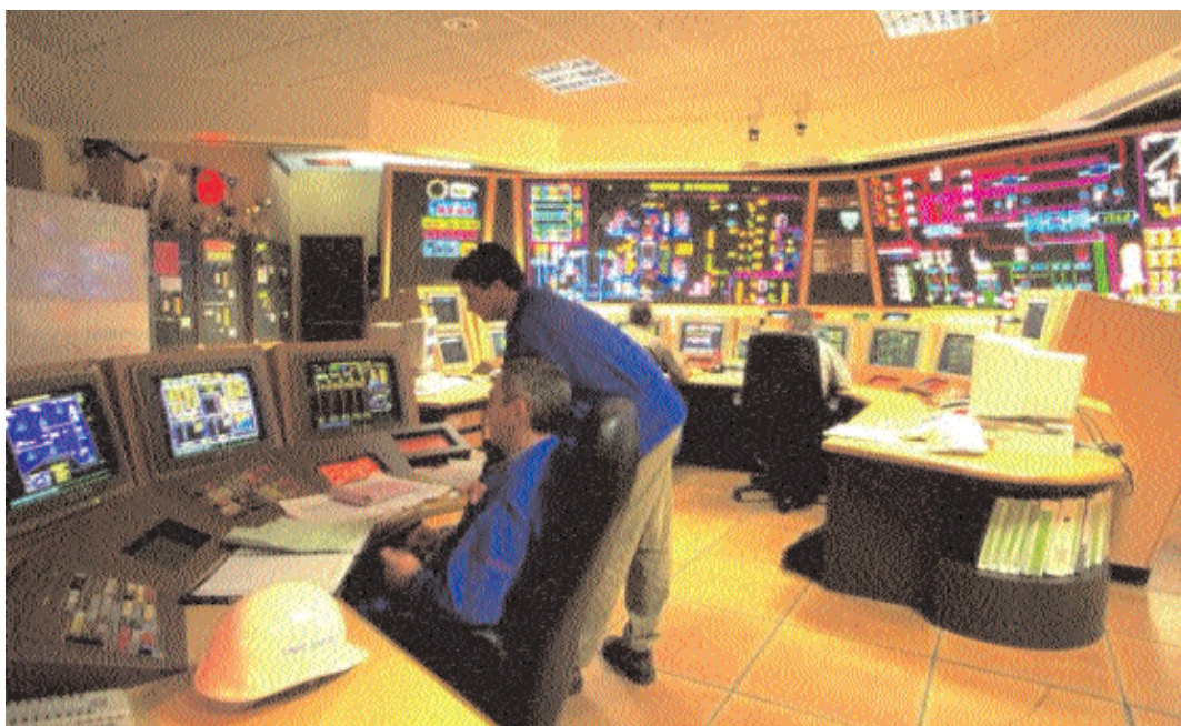
△ Salle de commande de la centrale de Chooz.
