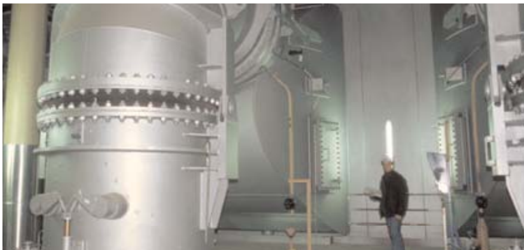
△ Entrée de l'eau de refroidissement dans le condenseur.
