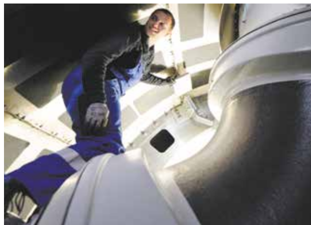
Une maintenance régulière doit être mise en œuvre pendant toute la durée de l'exploitation (estimée à 20 ans).
